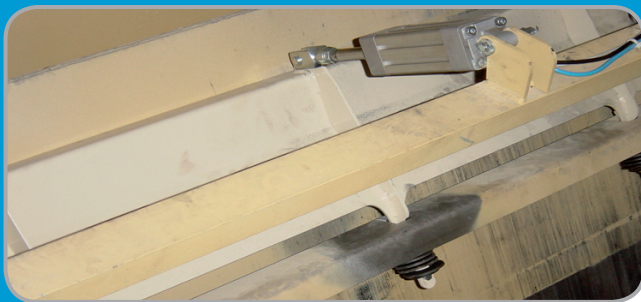
Compactador de Lodos
